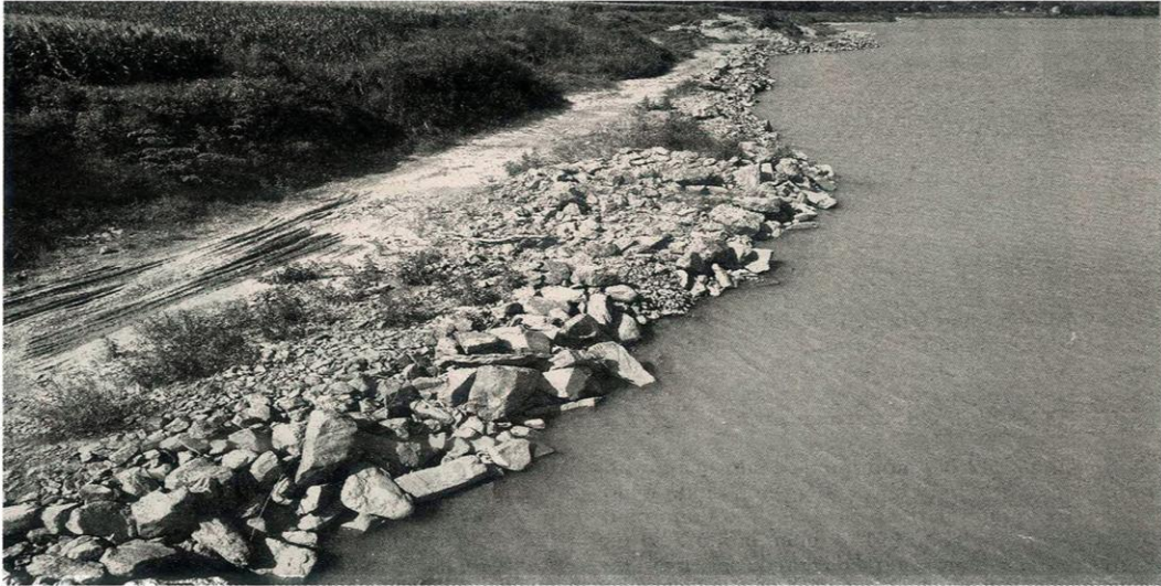
Công trình xử lý sạt lở bờ tả sông Mã tại các thôn Giang Đông, Nghĩa Kỳ hiện mới cơ bản hoàn thiện phần kè đá học.
